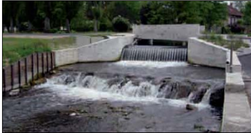
Figure 13 Exemple d'ouvrages visant à la fois la protection contre les inondations et celle de l'environnement (photo SIARCE)
